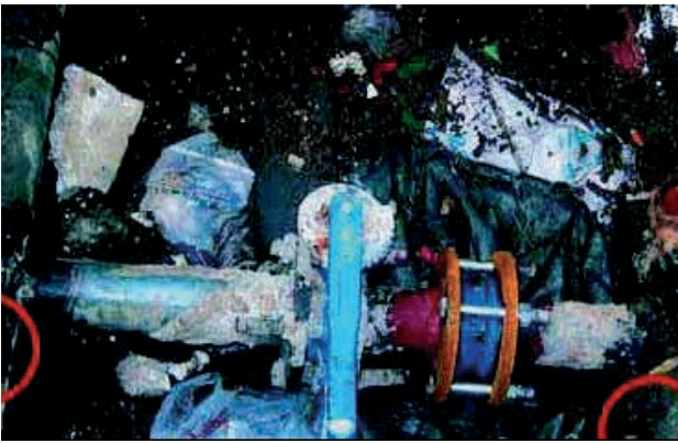
Abb. 19: Trinkwasserleitung (auf der linken Seite) durch ein Ventil mit der Abwasserleitung (rechte Seite) verbunden
